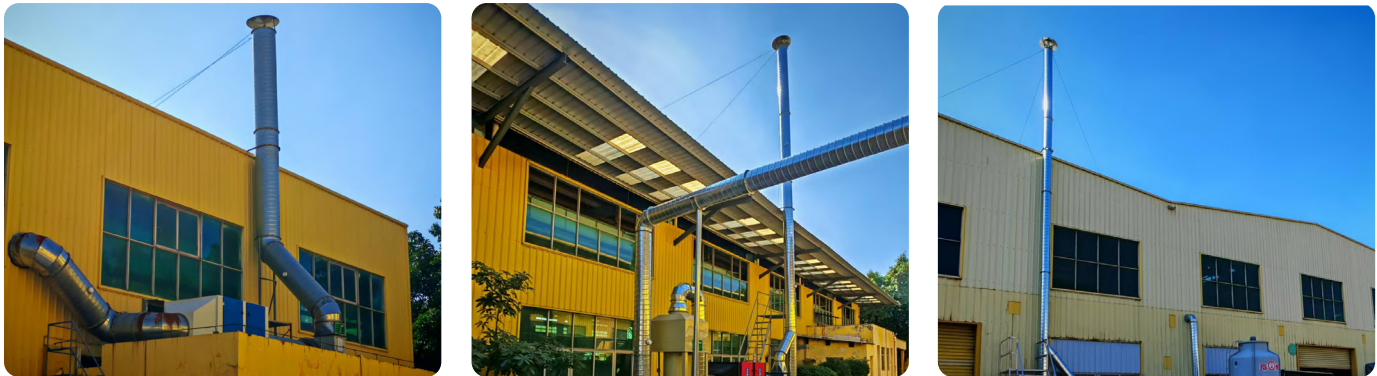
2025 漳州燦坤空氣污染收集處理新設備
